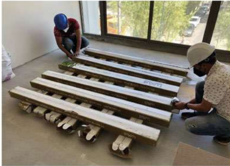
Forma de apilar las cajas para una correcta aclimatación
